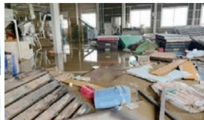
▲施設内部に泥水が浸水し、資材などが散乱しました
